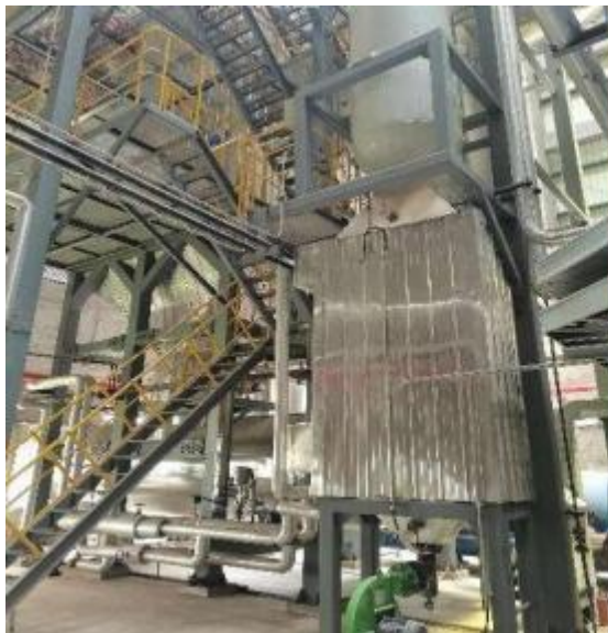
废气处理设施 SCR
