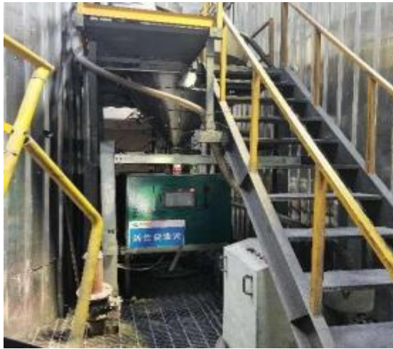
废气处理设施-活性炭装置
