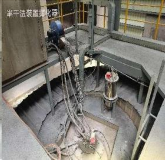
废气处理设施-半干法脱酸
