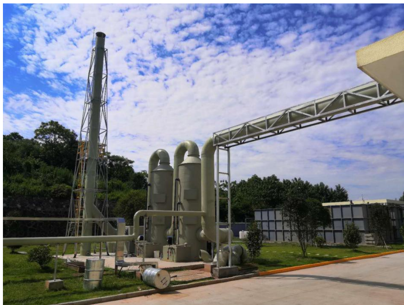
图 4-4 除臭废气处理设施
